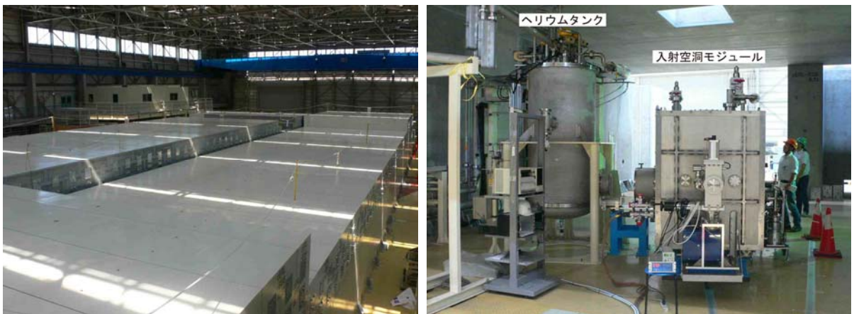
図2：ERL 開発棟内で建設が進むコンクリート製の cERL 用放射線シールド（左の写真）とシールド内の入射器ビームラインに設置された入射器用超伝導空洞モジュール及び 2K 液体ヘリウムタンク（右の写真）。
