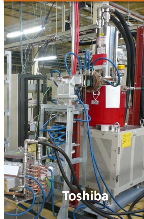
300 kW CW Klystron
