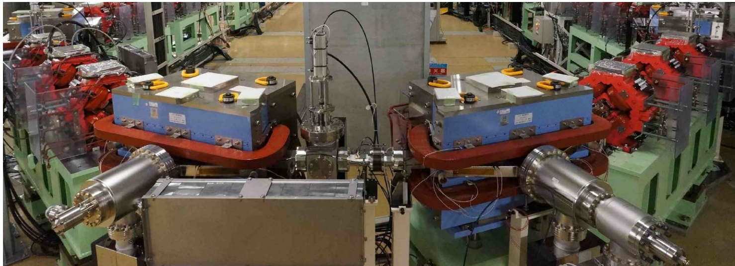
六極電磁石設置前のcERLアーク部(写真)
