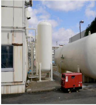
タンクの配管接続
