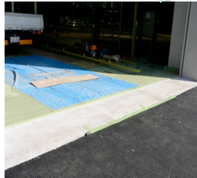
シャッター一部段差
