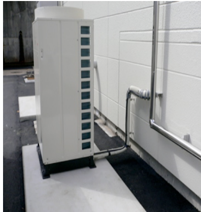
空洞開発部空調機の の室外機
