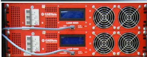
偏向電磁石電源 (上) 四極電磁石電源 (下)
