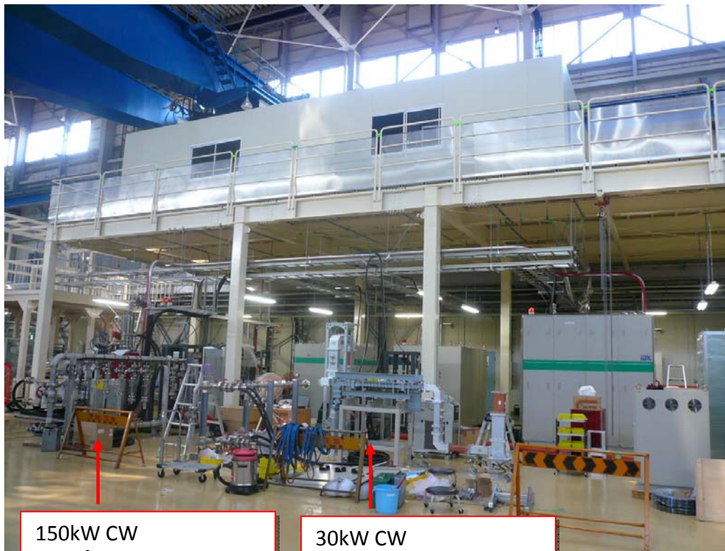
東カウンターホールのRF源の現状
