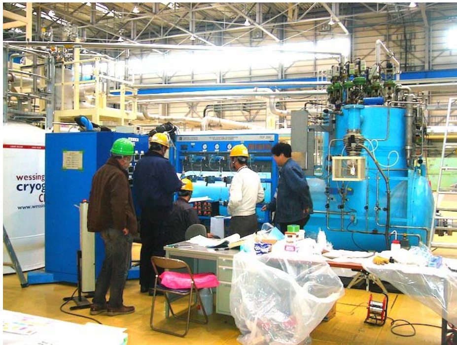
TCF200液化冷凍機(物材機構より移管)
