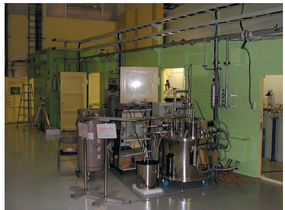
写真1) メインハッチ外部。液体窒素循環システムが設置されている。
