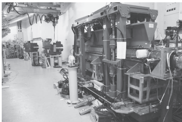
写真3 四極電磁石とビームダクトが撤去されたリング内、MPW#16 からその下流部をのぞむ。後方に見える2台の偏向電磁石の間に短直線部が新設され、短周期アンジュレータが設置される。
