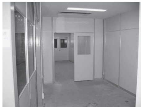
図3 BL-17A コントロールキャビン。今後床の補修作業が予定されている。
