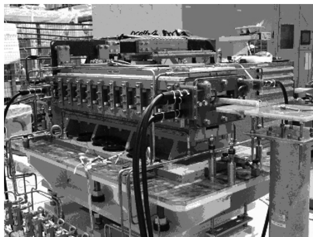
図 入射器終端に設置予定のパルス電磁石。磁極長は0.99 m、PF用電子ビームを6.55度偏向してPF輸送路に送る。最大磁場強度は約1.2テスラ、2.5 GeV ビーム入射時の磁場は0.96テスラ。
