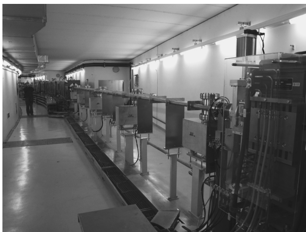
図1 12月25日、初蓄積翌日のSSRF光源リングトンネル内の様子。ここに写っている長直線部(12 m)や他の短直線部(6.5 m)にもまだ挿入光源は無く、SUS製のダミーダクトが設置されていた。
