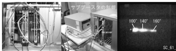
図2 (左) 主制御室近くのメイントリガーステーションに設置された Event Generator。(中) 第3セクターサブブースター「SB-3」電源付近に設置された Event Receiver と位相設定/モニター用 DAC/ADC。(右) 入射器終端に設置されているビーム偏向電磁石下流のスクリーンで観察したビームスポット。SB-3の位相を3種類(100°, 140°, 160°)変えることにより、第3セクター8台の大電力RF源の位相を同時に変えると、エネルギーの違いによりビームスポットが写真のようにずれて観測される(右方が低エネルギー側)。位相は20ms毎に変更し、「100-140-160-100-140」度のパターンを繰り返した(位相160度のビームパルスは他の1/2の頻度なので暗く見える)。
