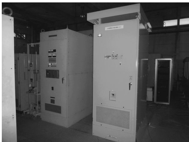
図3 PF-ARの新4極電磁石電源(右側)を示す。今回の4極電磁石電源の更新は、全20台の中の最大容量のQF電源1台のみであった。左側の電源は、既設4極電磁石(QD)電源である。
