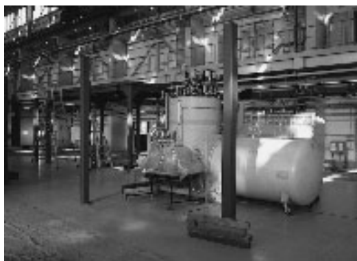
図6 東カウンターホール内ヘリウム冷凍設備の現況
