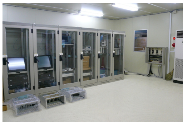
図4 LLRFの制御室に設置されたモジュールを搭載するラック・スタンド
