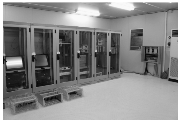
図 4 LLRF の制御室に設置されたモジュールを搭載するラック・スタンド
