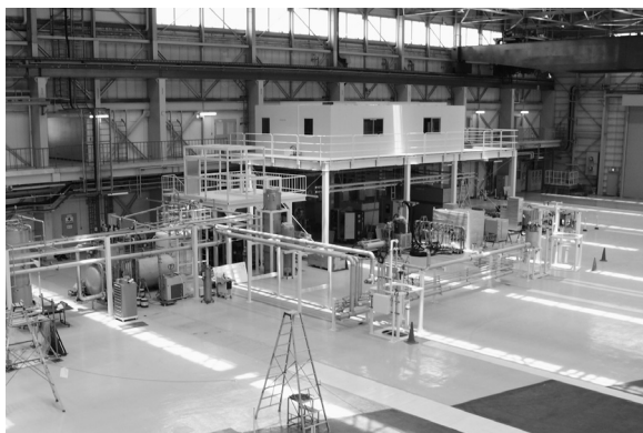
図 1 東カウンターホール内ヘリウム冷凍設備
