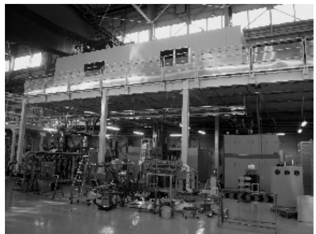
図8 RF 源の配置 (左に 300 kW クライストロンと中央に 30 kW IOT)。2 階部のプレハブ内では low level RF の準備を進めている。
