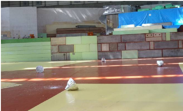
図1 地震の衝撃で落下した ERL 開発棟の照明
