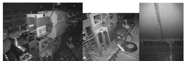
図6 PF-ARトンネルのエキスパンションジョイント部にみられたひび割れと湧水の増加。床から泥水が噴き上げた痕跡がみられた。
