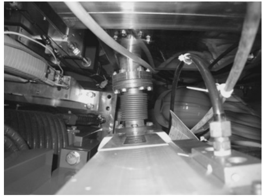
図5 ビーム輸送路からセプタム電磁石への接続部にみられたベローズの曲り。
