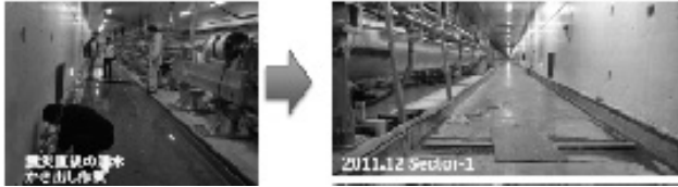
図6 トンネル湧水はかなり少なくなった。
