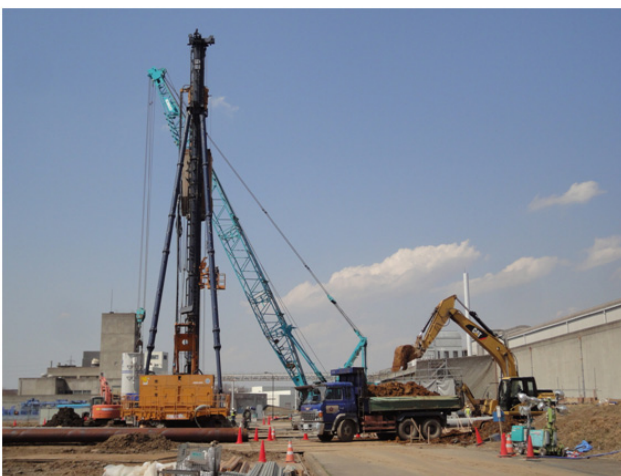
図1 入射器の西側で進むダンピングリング建設のための杭打ち作業。並行して A1 電子銃室拡張工事、加速管準備室拡張工事なども進んでいる。
