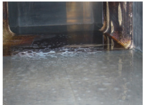
図2 冷却水漏れを起こしたサーキュレータ(上図)。下図はサーキュレータ内部の様子。
