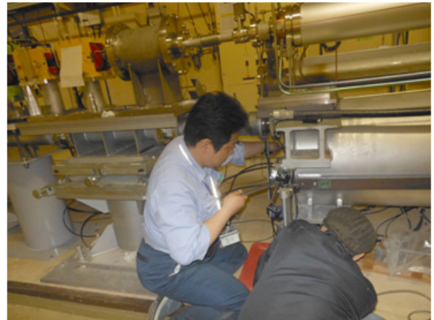
図1 震災を受けた架台を修復しながらアライメントを進めている。
