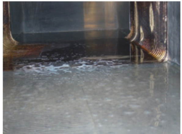
図2 冷却水漏れを起こしたサーキュレータ (上図)。下図はサーキュレータ内部の様子。
