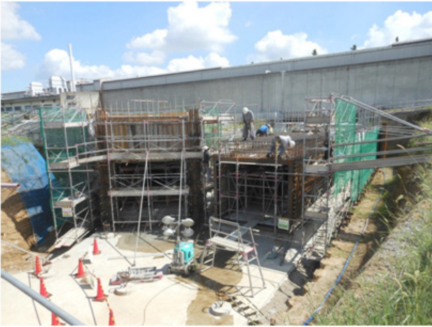
図3 ダンピング・リングの基礎工事が終わり、トンネルの構築が進んでいる。
