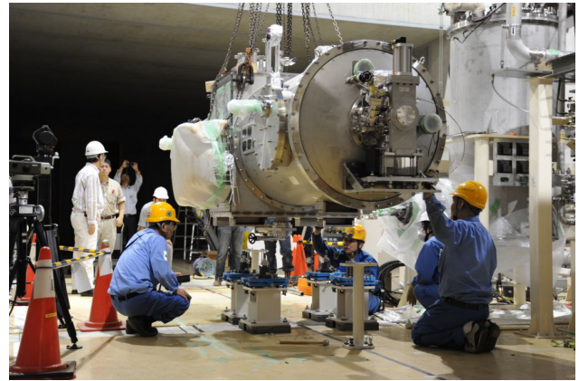
図5 現場に設置された主加速部超伝導空洞クライオモジュール。
