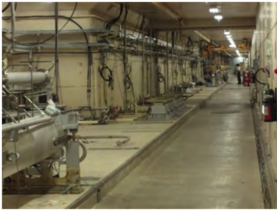
図3 旧陽電子生成部が撤去され、新規改造架台の運びこみを待つ第1セクタ後半部。
