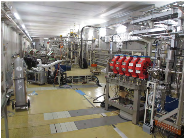
図1 7月からの作業で交差部のダクトが早々に取り外された現場。
