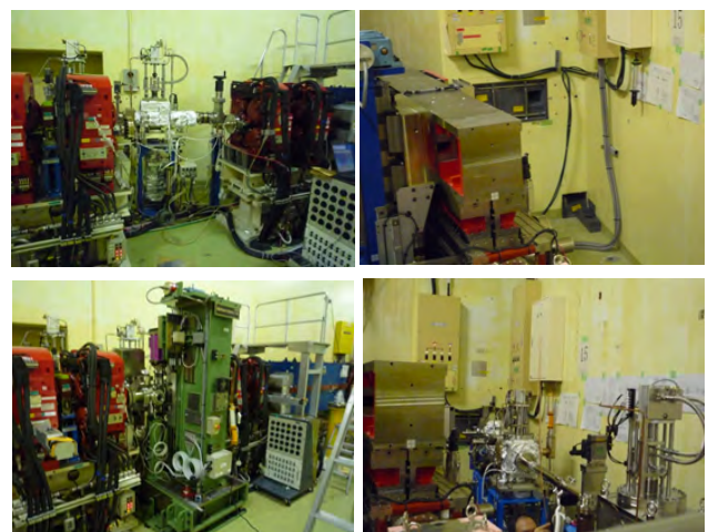
図2 新ビームラインBL-15のアンジュレータの設置前(左上)と設置後(左下)と基幹チャンネルの設置前(右上)と設置後(左下)。
