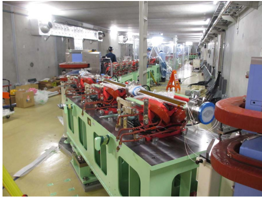
図2 (上) 測量をしながら真空ダクトを設置している様子。(下) 設置が完了した南側の直線部。
