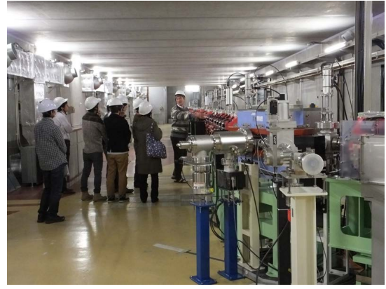
図5 東京工業大学の学生達と cERL を見学している様子。
