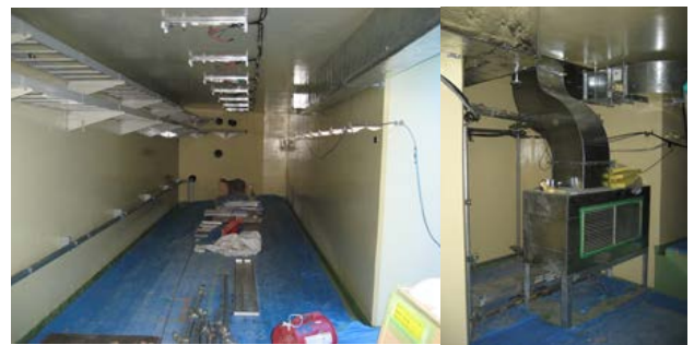
図3 左写真はトンネル内の一部である。壁の塗装が終了し、左上部に2段のケーブルラダー、左下部には排水用水配管、中央上部には照明機器、右上部には空調吹き出し口が通っている。奥に見える壁は共同溝と交わる部分。右写真は、空調吸い込み口の場所。
