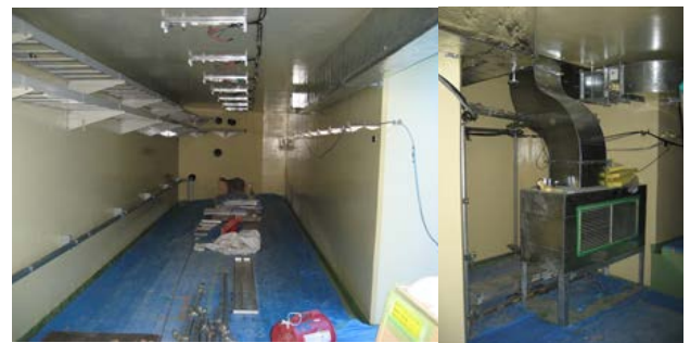
図 3 左写真はトンネル内の一部である。壁の塗装が終了し、左上部に 2 段のケーブルラダー、左下部には排水用水配管、中央上部には照明機器、右上部には空調吹き出し口が通っている。奥に見える壁は共同溝と交わる部分。右写真は、空調吸い込み口の場所。
