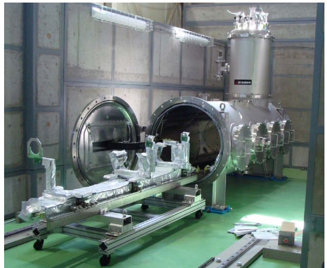
図1 9月下旬に AR 東第2実験棟のコンクリートシールド内に据え付けが完了した横型クライオスタット。
