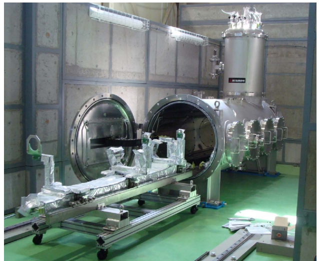
図1 9月下旬に AR 東第2実験棟のコンクリートシールド内に据え付けが完了した横型クライオスタット。
