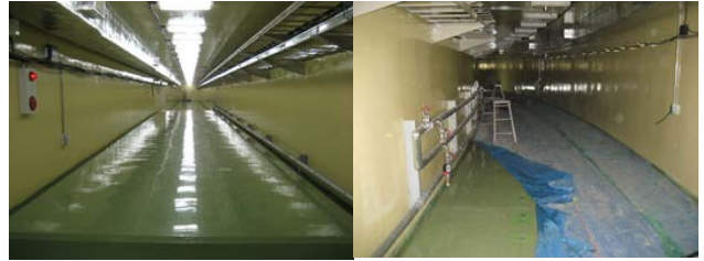
図 2 PF-AR 直接入射路トンネル直線部 (左図)、およびアーク部 (右図) の様子。
