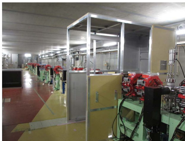
図2 恒温壁が建設された加速器室内の様子(11月)。
