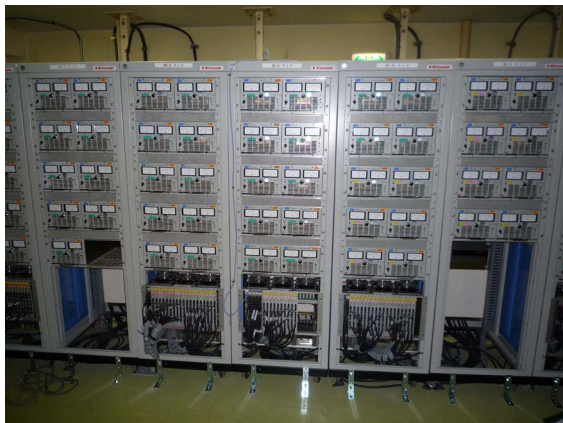
図2 PFリングの小型電磁石電源とその制御系の一部。
