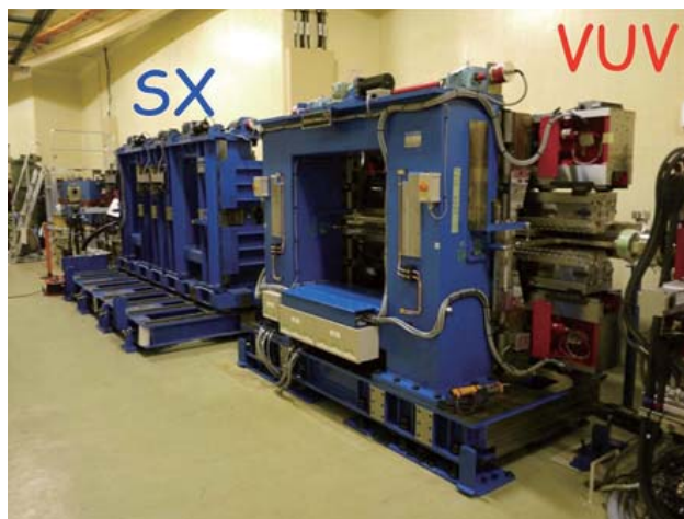
図2 BL-2長直線部に設置された真空紫外(VUV)用および軟X線(SX)用アンジュレータ。
