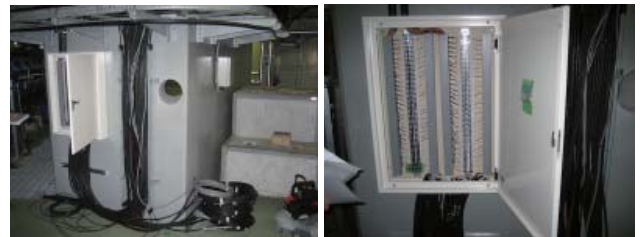
図2 PF-ARリングトンネル内に設置された電磁石用インターロックボックスを示す。インターロックボックス左にある壁穴を、ビーム輸送路の真空チャンバーが通過する。
