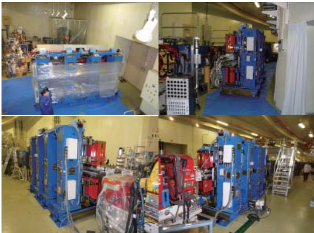
図1 上図はU#13(APPLE-II型可変偏光アンジュレータ)をPF光源棟内に搬入・移動している様子。下図は、U#13をB12-B13間の直線部に、U#28をB27-B28間の直線部に設置した様子を示す。
