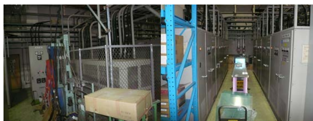
図5 PFリングの偏向電磁石電源の受電盤（左）と大型4極、6極電磁石電源（右）。
