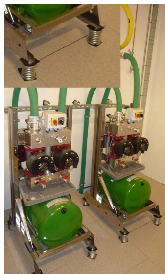
図 4 スプリングを挟んだ冷却水ポンプの設置。台車に乗ったスクロールポンプなども含め、機械振動を引き起こすもの全てにスプリングが挟んであった。
