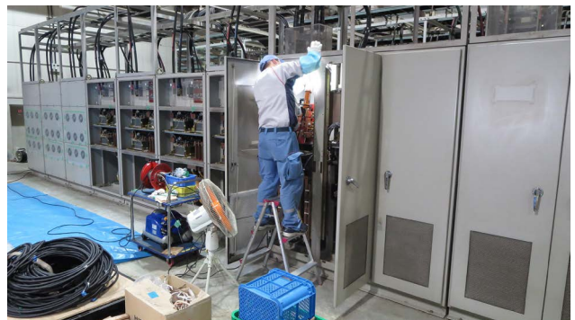
図4 PF電源棟に設置してある大型電磁石電源の保守作業の様子。
