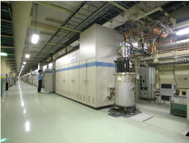
図2 入射器クライストロン・ギャラリに設置されている大電力パルスモジュレータ電源とクライストロン。
