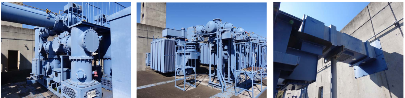
図1 PFエネルギー・センター内の設備、左から、共同溝からの66 kV受電部、6.6 kVへの変圧器、6.6 kVのブスバーを覆うダクト。ダクトの下にあるメッシュから多湿の温風が侵入したと考えられる。
