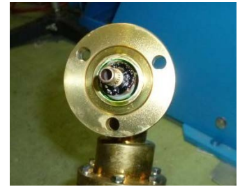
図6 故障した HOM ケーブルに付属する L 型アダプタ (ダミーロード側)。絶縁体のポリエチレンが黒色に変色していた。
