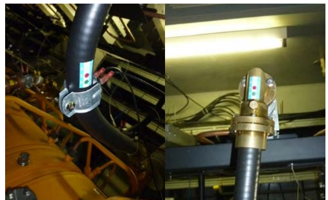
図9 故障した HOM ケーブルのサーモラベル表示。(左) 中央部、(右) ダミーロード側。いずれも50°C以上を示す赤色と60°C以上を示す緑色のサインが表示されていた。
