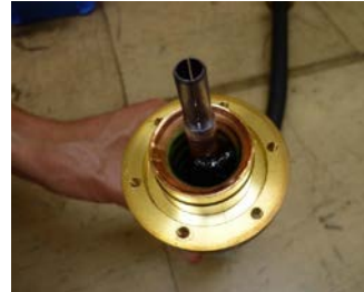
図7 故障した HOM ケーブルの端のコネクタ (ダミーロード側) を外したところ。絶縁体のポリエチレンはよりひどく変色し溶けていた。
