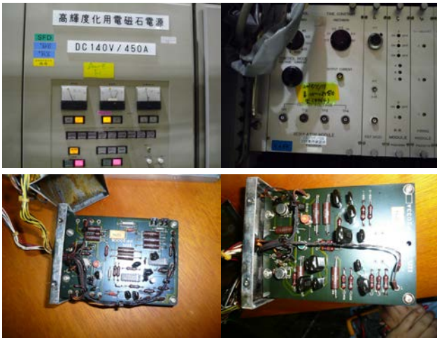
図2 PFリング立ち上げの5月7日に故障したSFD(6極電磁石: 1994年製造)電源。上右図の黒いダイヤルが3つについているモジュールが故障したモジュールで、下図がモジュール内部の基板。内部基板は焦げ、抵抗2個破裂、配線も焦げているのが分かった。
