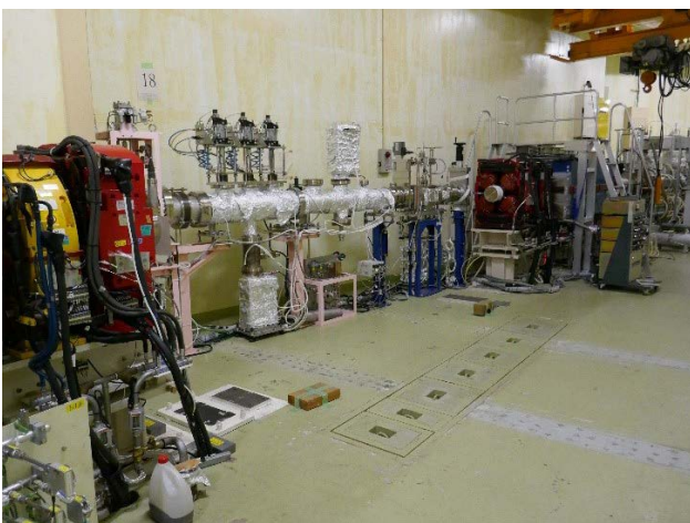
図1 R#19撤去前後のB18-B19間直線部の様子を示す。R#19設置のために補強していたH鋼も撤去され、B18-B19間のトンネル内側がフラットな状態になった。
