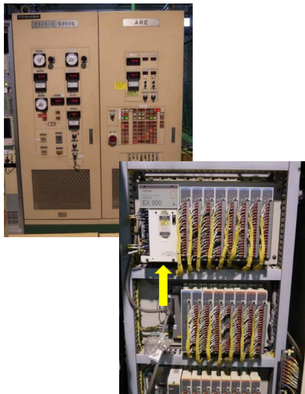
図7 クライストロン用高圧電源制御盤（1988年製）（左上図），および制御盤内の故障したPLC（右下図黄色矢印）。
