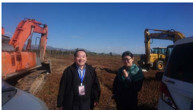
図2 北京放射光建設現場。まだ形は何もなく広い土地があった(PFの兵藤一行先生(左)と総研大D1三木宏美さん)。
