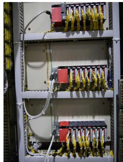
図8 更新されたPLC
