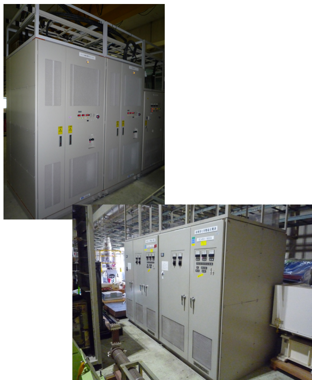
図3 PFリングの新規に製造された4極電磁石電源2台(左上)と交換され保管されている旧4極電磁石電源(右下)
