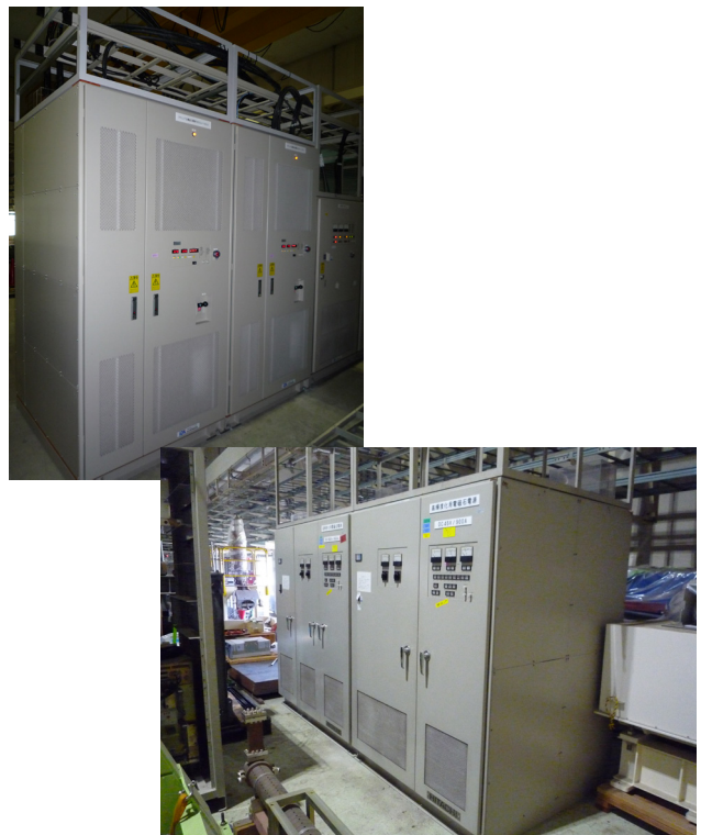
図3 PFリングの新規に製造された4極電磁石電源2台(左上)と交換され保管されている旧4極電磁石電源(右下)
