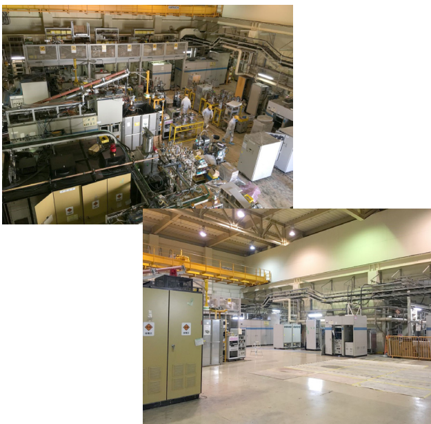
図1 被災直後のクライストロン組立ホール（左上），と回復作業の進んだ最近のホール（右下）
