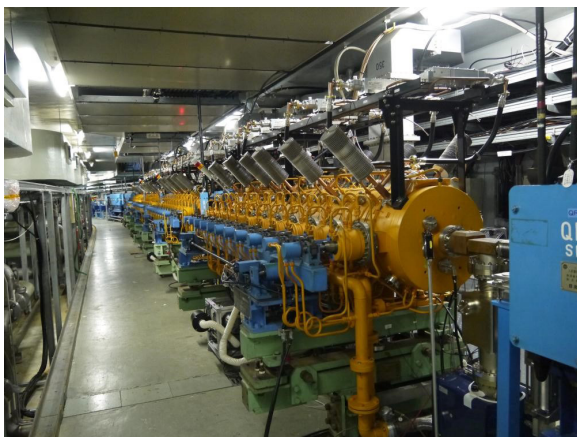
図 3 PF-AR の APS 型加速空洞 (東直線部に設置された 4 台)
