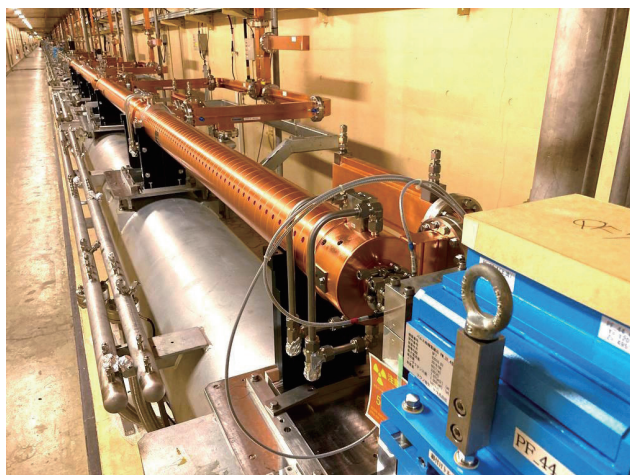
図 3 #44 ユニットに設置された 4 本の新規の加速管
